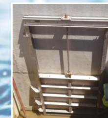
Système d'isolation des eaux polluées
